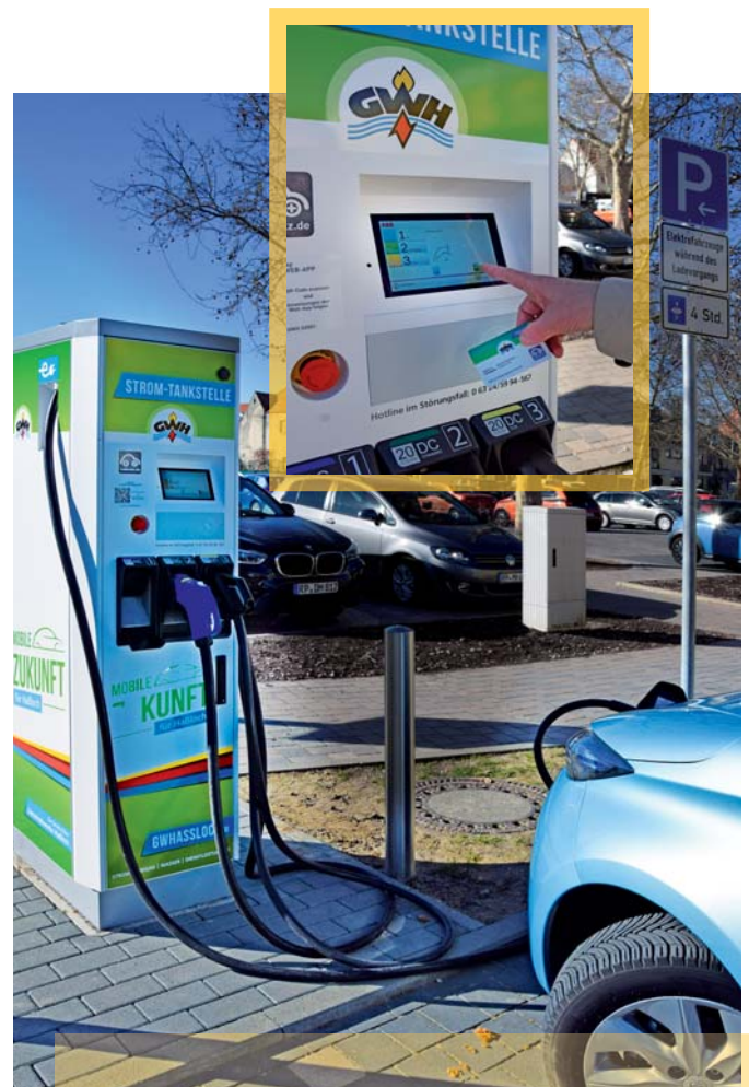
Schnell-Ladesäule der GWH in der Schillerstraße, Haßloch
