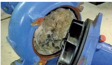
Defekte Pumpe! Verstopft mit Feuchttüchern!
