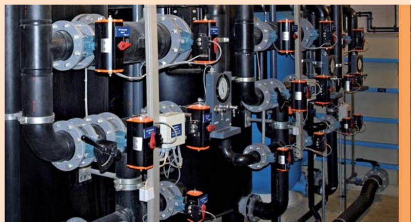
Umwälzanlage und Wasserkontrollwarte sind im Hallenbad Mosbach auf dem neuesten Stand der Wassertechnik
