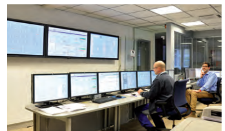
Jede Menge Bildschirme: Die Versorgungsspezialisten der Stadtwerke Mosbach überwachen rund um die Uhr alle Systeme an insgesamt zwei Dutzend Bildschirmen.
